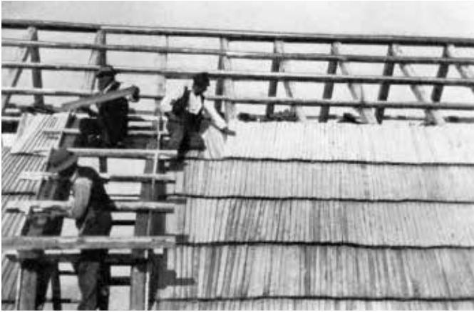
Im Rahmen des staatlichen Wiederaufbauprogrammes wird das Stallgebäude auf der Feistritzer Alm eingedeckt, 1928.
